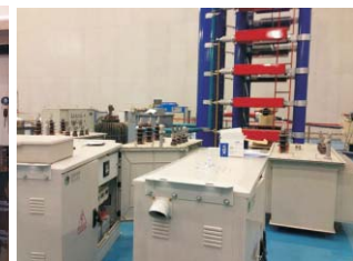
VSK补偿装置在电科院试验现场
